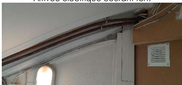
Circuit courant faible
