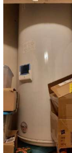
Ballon d'eau chaude électrique
