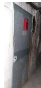
Local machinerie au sous-sol
