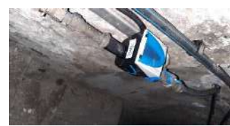
Arrivée d'eau froide générale
