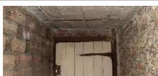
Absence de revêtement
