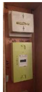
Compteur électrique ascenseur
