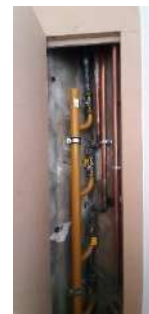
Gaine gaz ventilée
