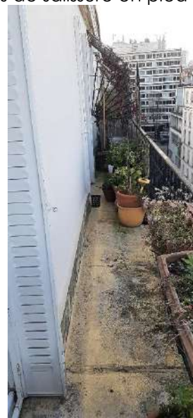
Traces de salissures sur les balcons
