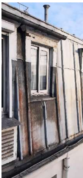
Brisis zinc R+5 côté cour avec traces de salissure et de blanchissement importantes
