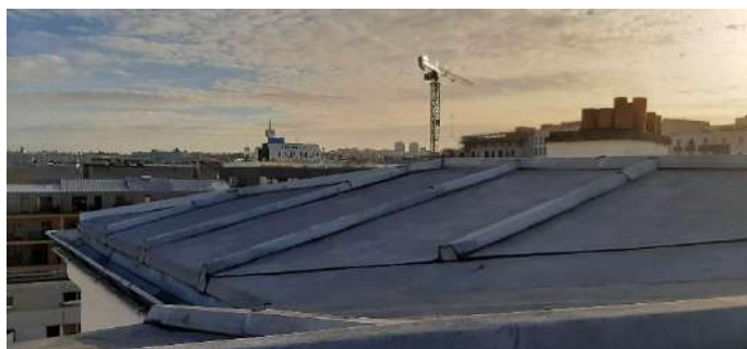
Blanchissement du zinc
