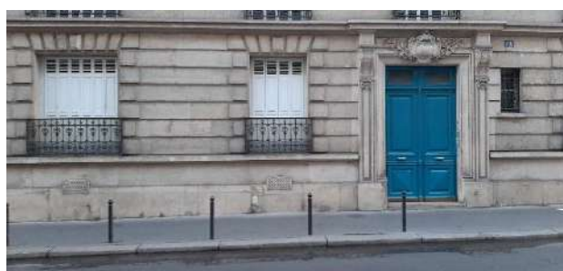
Traces de salissure en pied de mur
