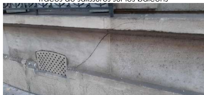
Fissures en façade
