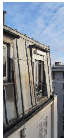
Blanchissement important des brisis et chéneau détérioré.
