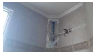
Colonne montante d'eau
