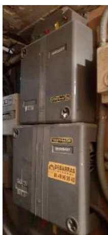
Arrivée électrique courant fort.
