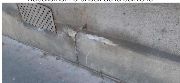
Décollement d'enduit au niveau des soubassements et détérioration de la pierre
