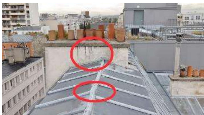
Zinc détérioré et décollement d'enduit sur les souches
