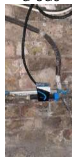
Deuxième compteur d'eau froide
