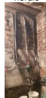
Réseau d'eau froide en sous-sol
