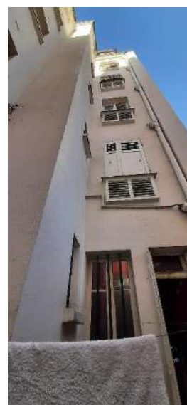
Descente d'eau pluviale mélangé aux descentes d'eau usées
