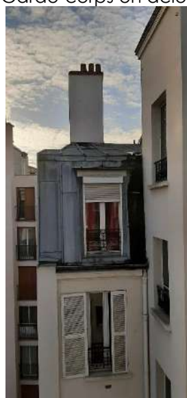
Brisis cour R+6 avec traces de salissures importantes
